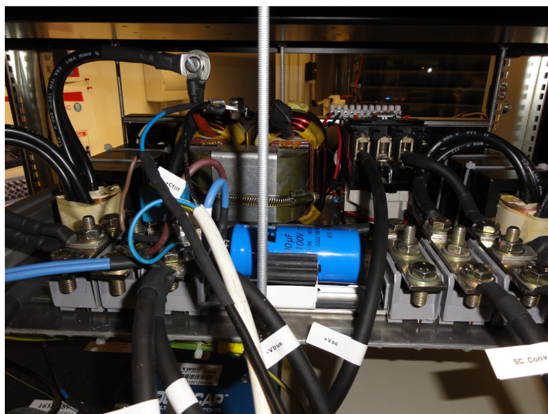
Figura 5.32: Filtro de la PC L - C e inductores de los convertidores
