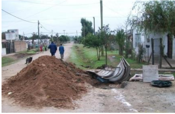
Fig. 11: Ocupación de la vía pública por materiales y resto de obra. OI
