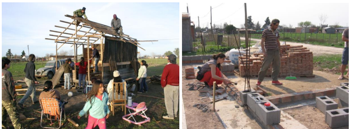
Fig. 1 y 2 – Construcción del Comedor provisorio. Y comienzo de los trabajos del Comedor definitivo
