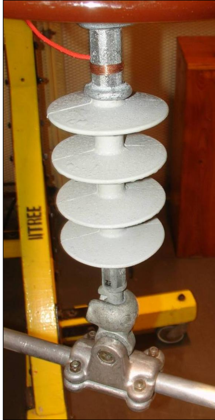
Figura 10.- Aislador en estudio y aspecto del rocío sobre el mismo
