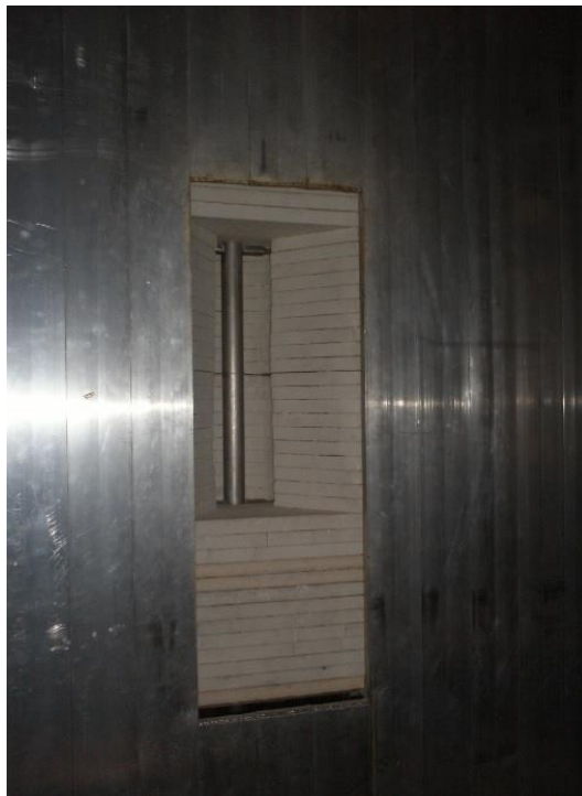
Figura 4.9a. Zona del equipo expuesta a la energía solar concentrada
