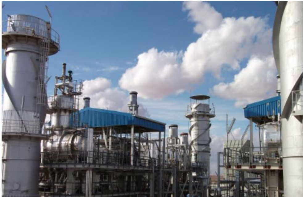
Figura 1.8. Central híbrida solar-gas Hassi R'Mel
