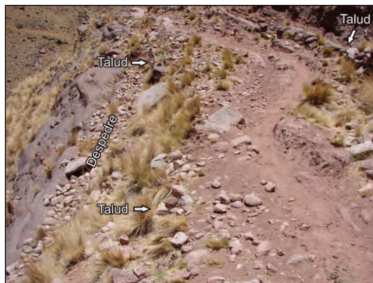
Figura VI.131. Posible despedre a la vera del camino.
