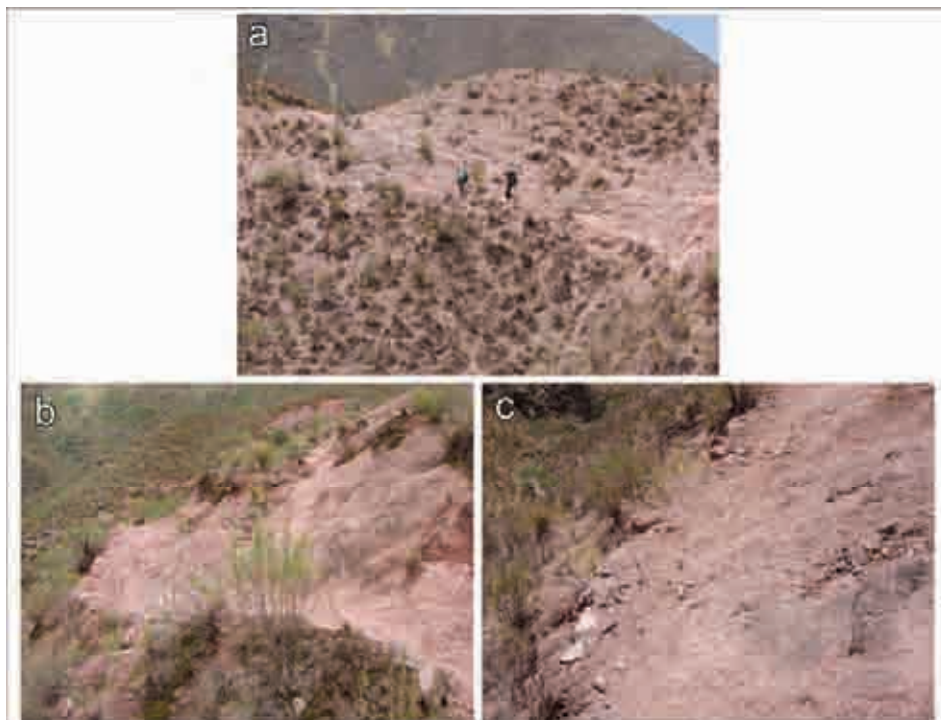
Figura VI.54: a) Ladera norte del Abra de Las Cuestas; b) y c) Se puede observar que el muro de contención de rocas no es continuo y que aparece un bordillo formado por rocas pequeñas, barro y vegetales a manera de muro de protección. Fotografías del autor.
