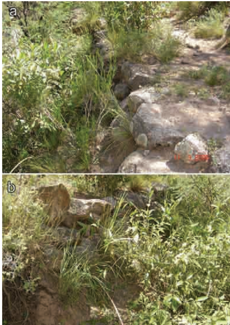
Figura VI.14: a) parte superior del muro de contención ladera abajo; b) el mismo muro visto de frente. Fotografías del autor.
