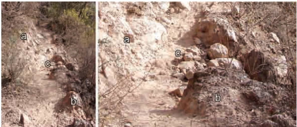
Figura V.65: a) excavación dentro de la ladera; b) bordillos de grava y sedimentos de menor granulometría (pelitas y/o psamitas); c) talud o muro de contención de rocas.
