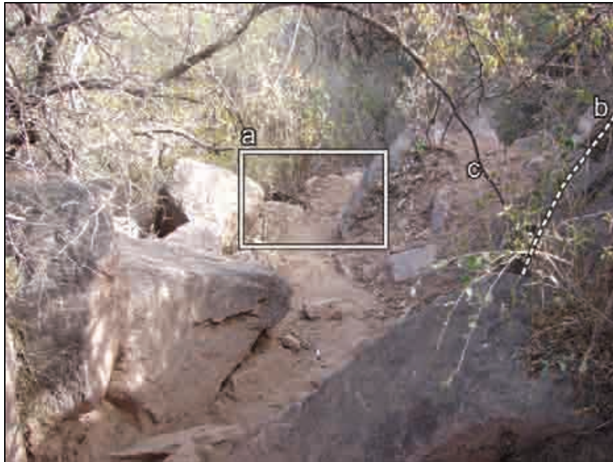
Figura V.68: a) Talud o muro de contención sobre el borde externo; b) Excavación sobre el borde interno (dentro de la ladera); c) Sector de derrumbe sobre la traza. Fotografía del autor.
