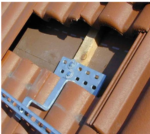
Gancho de anclaje puesto con carril transversal atornillado
