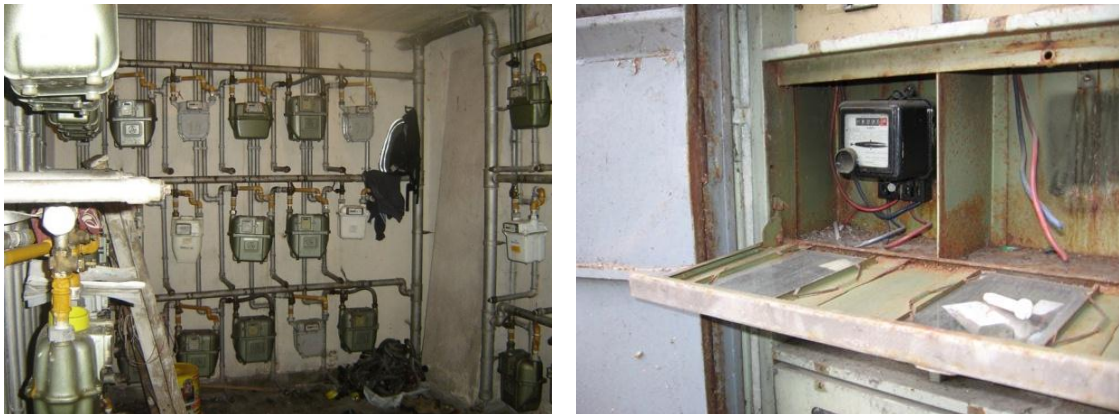
Figuras VI – 1 y 2: Sala de medidores de gas natural y de energía eléctrica de uno de los edificios auditados.
