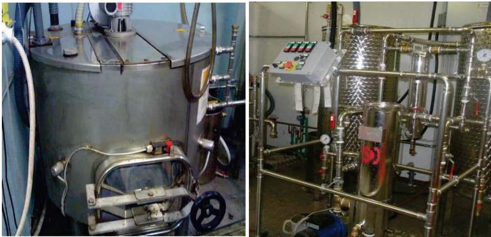
Fig. 1.3 – Fotografías del reactor y de la planta piloto para la obtención de los SBO. Fuente [7].
