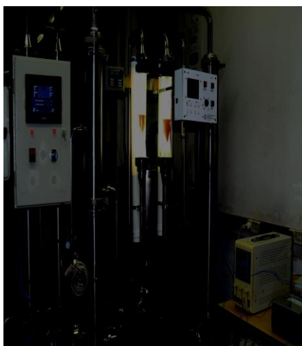
Figura 1: Planta piloto con el transductor montado
