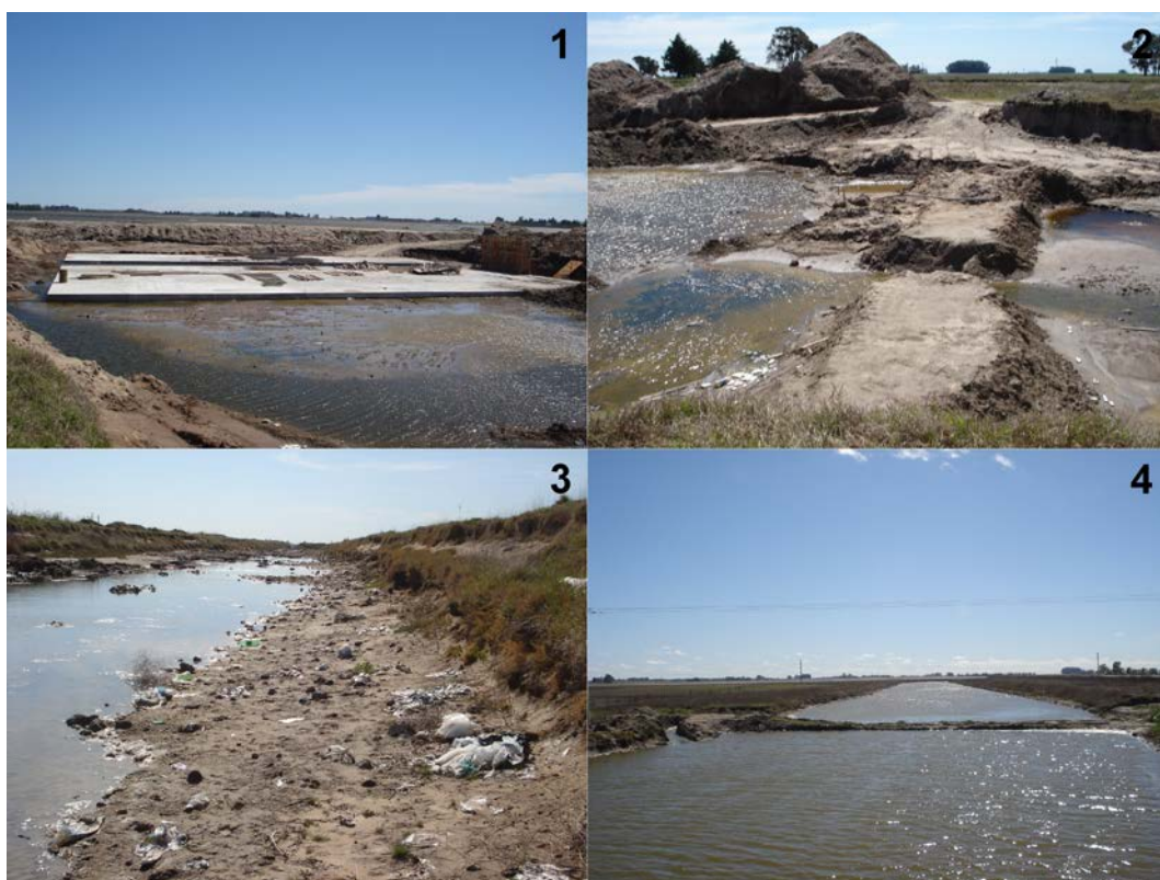
Figura 2.10: Referencias: 1 y 2 – Obras en las cabeceras del Aº Saladillo (sept. 2009), durante la construcción de un nuevo vertedero en la laguna del Bragado (comparar con las fotos 3 y 4, Fig. 2.8). 3- Canal Mercante (sept. 2009 - aguas muy bajas ); nótese la presencia gran cantidad de residuos. 4- Vista del muro de contención construido en el Canal de Vinculación en sept. 2009 ( aguas muy bajas ), aguas abajo del sitio de muestreo, hacia la laguna del Bragado (fondo). El flujo de agua corría por una derivación en el margen izquierdo.
