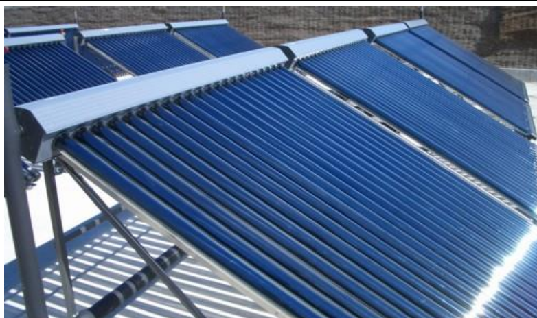
Figura 2.20: Instalaciones de colectores solares para calefacción por agua. Fuente: www.solarcel.mx
