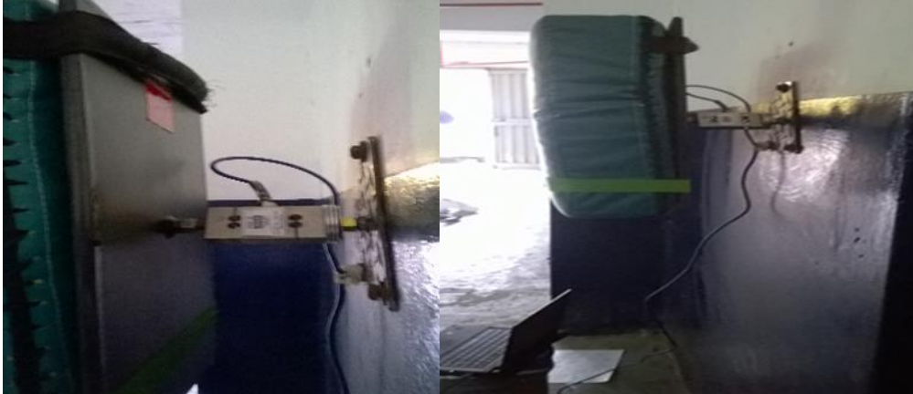
Fig.2 Celda de carga instalada con escudo de potencia.
