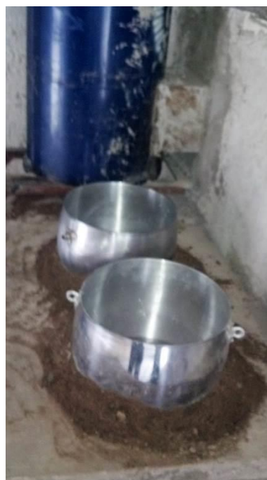
Figura 14. Solución provisoria de fuga de gases
