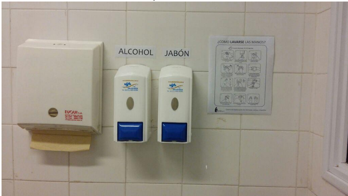
Imagen 7 - Filtro Sanitario – instalación de dispensadores de jabón y alcohol; e instructivo para lavado de manos
