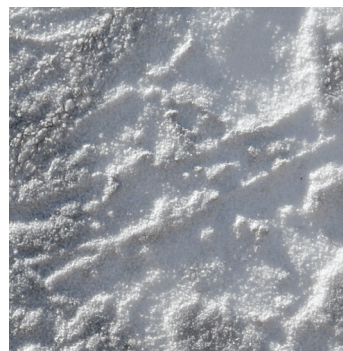
Pérdida de cohesión granular
