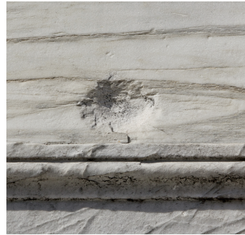
Daño por impacto
