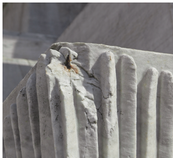
Elemento oxidado que produce fragmentaciones y desprendimiento de material
