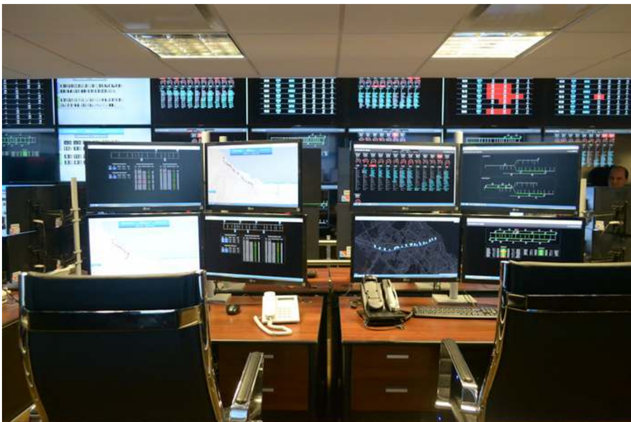
Puesto de Mando del CTC (Control de Tráfico Centralizado)
