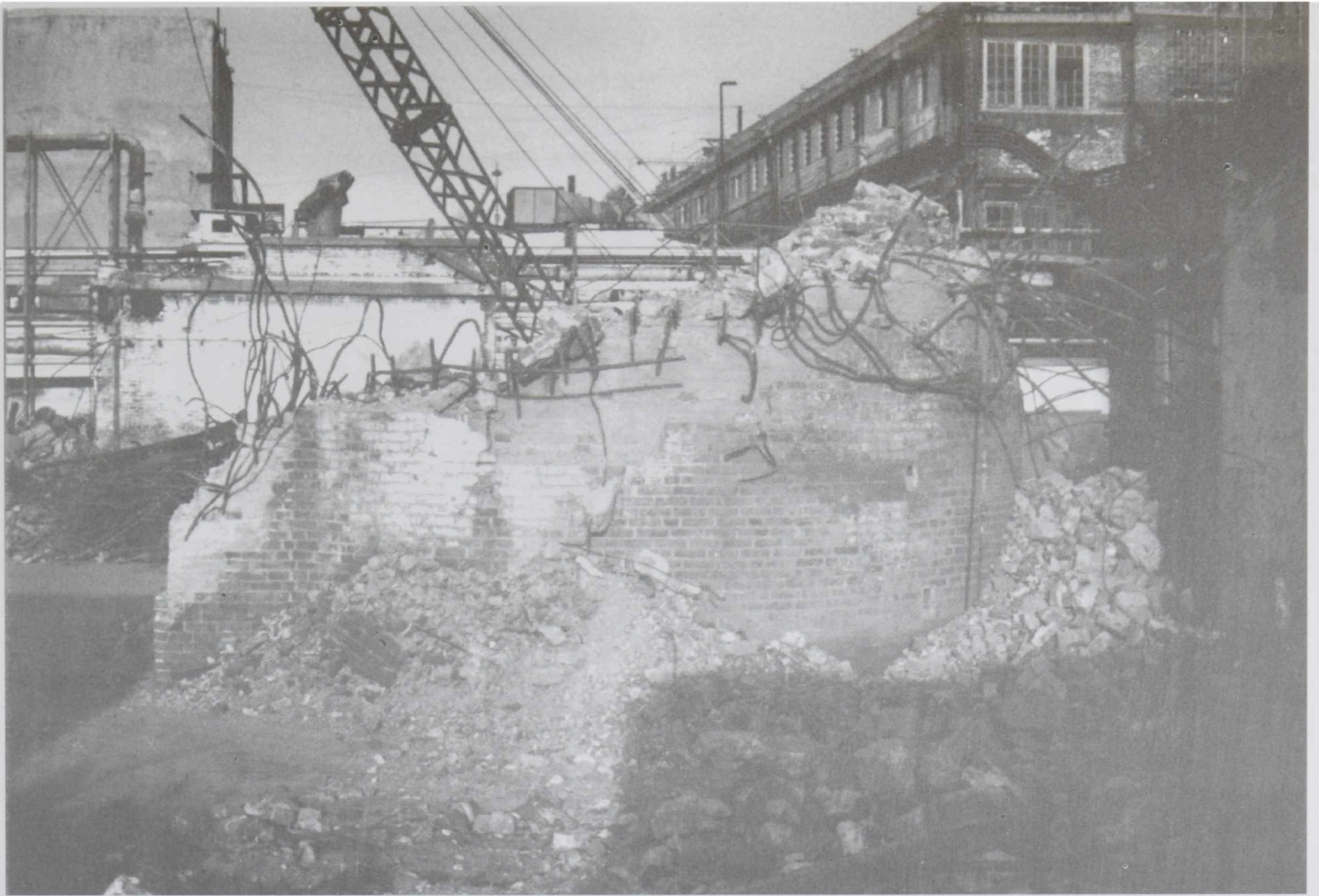
1984- Swift. Demolición de la chimenea. Un símbolo de lo que fue Berisso
