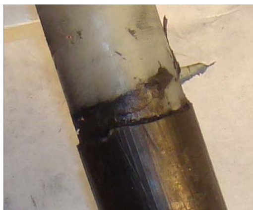
Fig. 17. Extremo de la capa semiconductor defectuosa y degradación de la masilla
