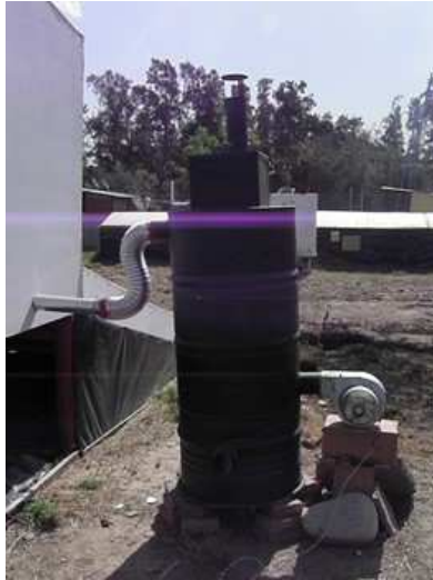
Foto 1.- Calentador auxiliar conectado a la cámara de secado.
