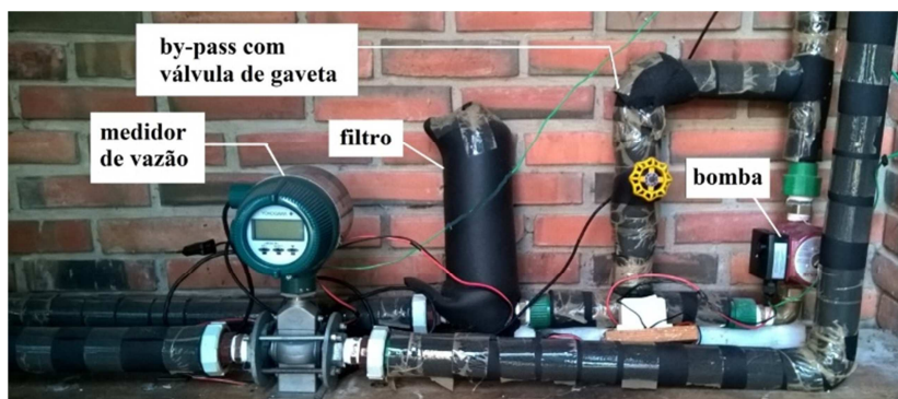
Figura 5: Imagem dos equipamentos utilizados na tubulação do fluxo de água.
