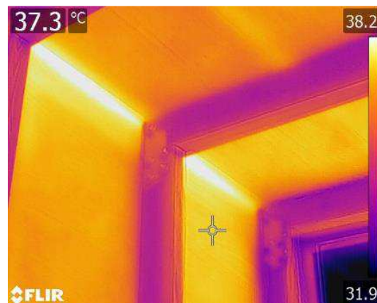
Puente térmico en la arista Alta temperatura superficial del muro 37,3° C, y 38° C en el puente térmico en la arista.
