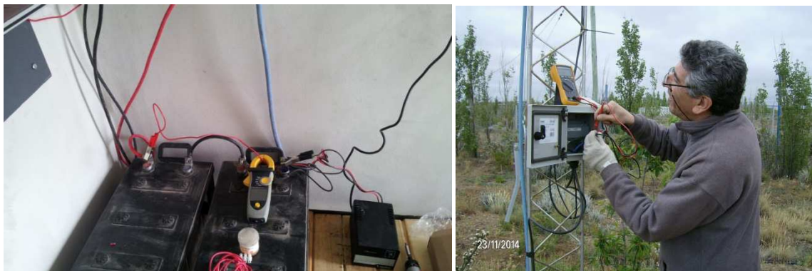
Figura 7: Banco de baterías en Chacra UASJ y unidad METEO.
