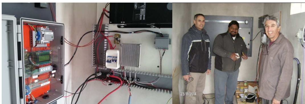
Figura 6: Tablero instalado 11-2014 con componentes de medición, Inversor QMax y rectificador
