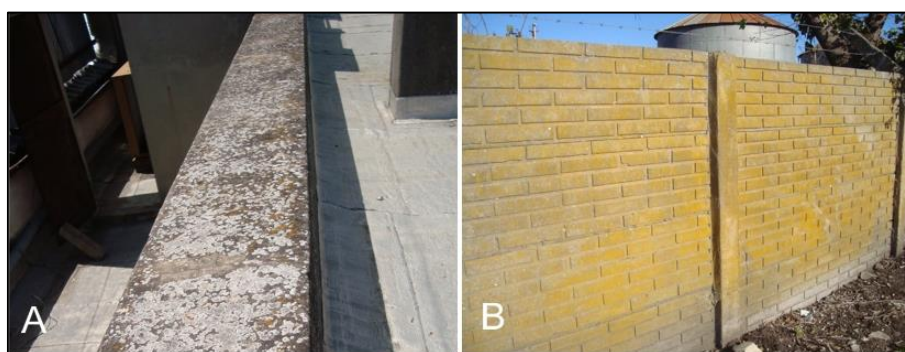
Figura. IV.2. A= muro horizontal colonizado por líquenes; B= muro vertical colonizado por líquenes
