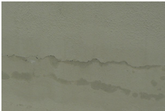
Fig. 5. 8 Fisuras por asentamiento plástico
