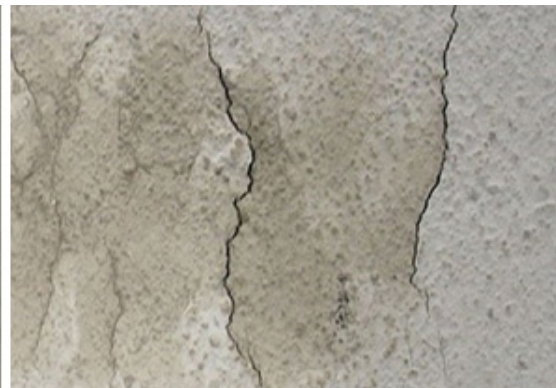
Fig. 5. 9 Fisuras por retracción plástica
