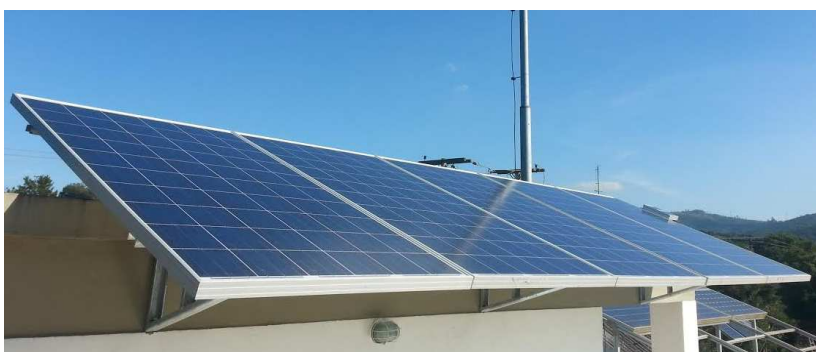
Figura 1: Arranjo instalado com 20 graus de inclinação.
