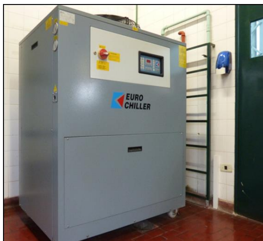
Figura 1.9. Módulo de refrigeración marca Euro Chiller, acoplado al equipo APH Stansted Fluid Power Ltd. High Pressure Iso-Lab System modelo FPG9400:922.
