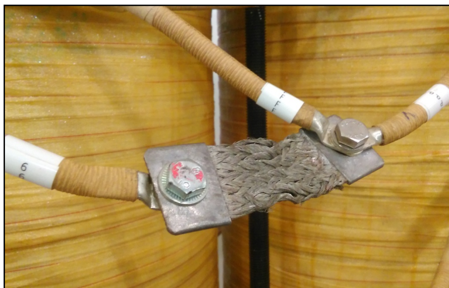
Figura 42: "Cortocircuito entre espiras".
