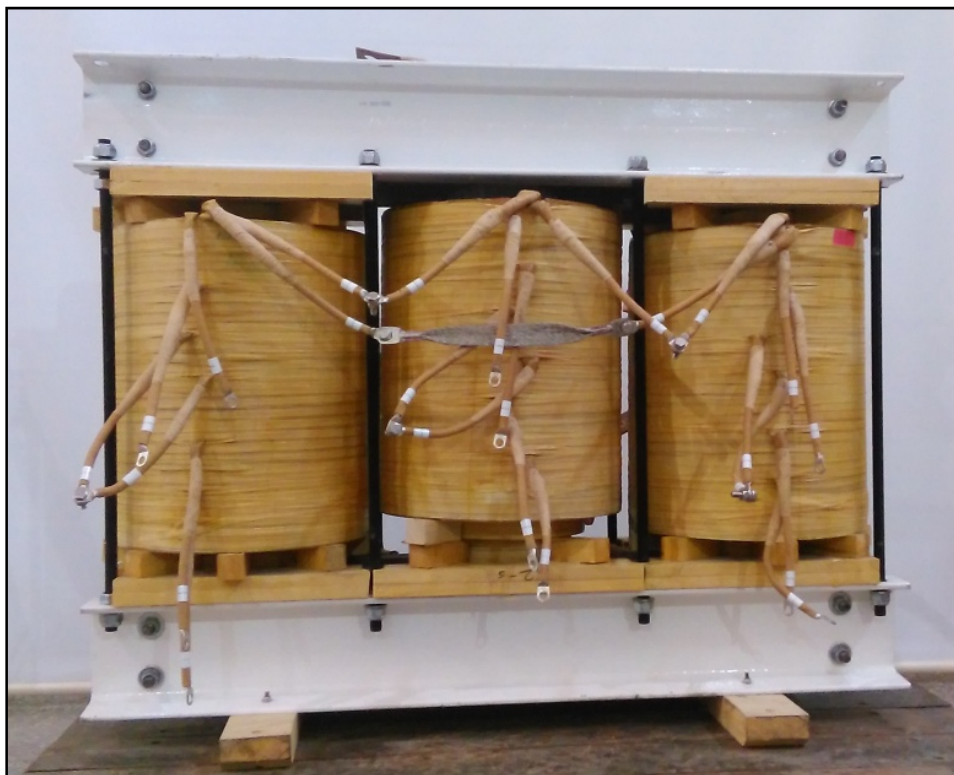
Figura 122: "Bobinado central de AT desplazado hacia arriba".
