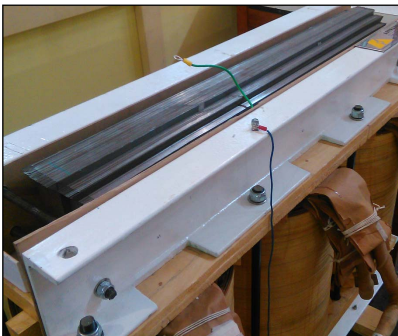
Figura 95: "Núcleo levantado (cable verde) y yugo conectado a tierra (cable azul)".
