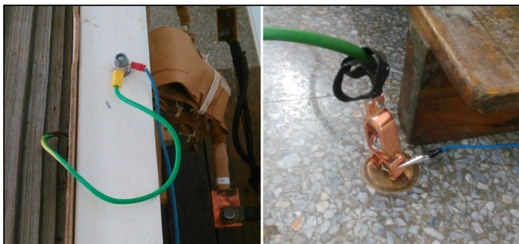
Figura 81: "Puesta a tierra original del núcleo".
