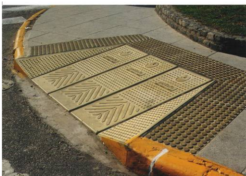
Rampa premoldeada con material antideslizante
