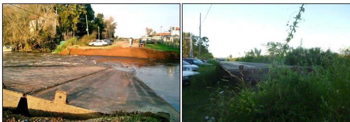
Figura 54: Hundimiento y abandono del puente Fuentes: www.argentina.indymedia.org , Vallejo, febrero de 2017
