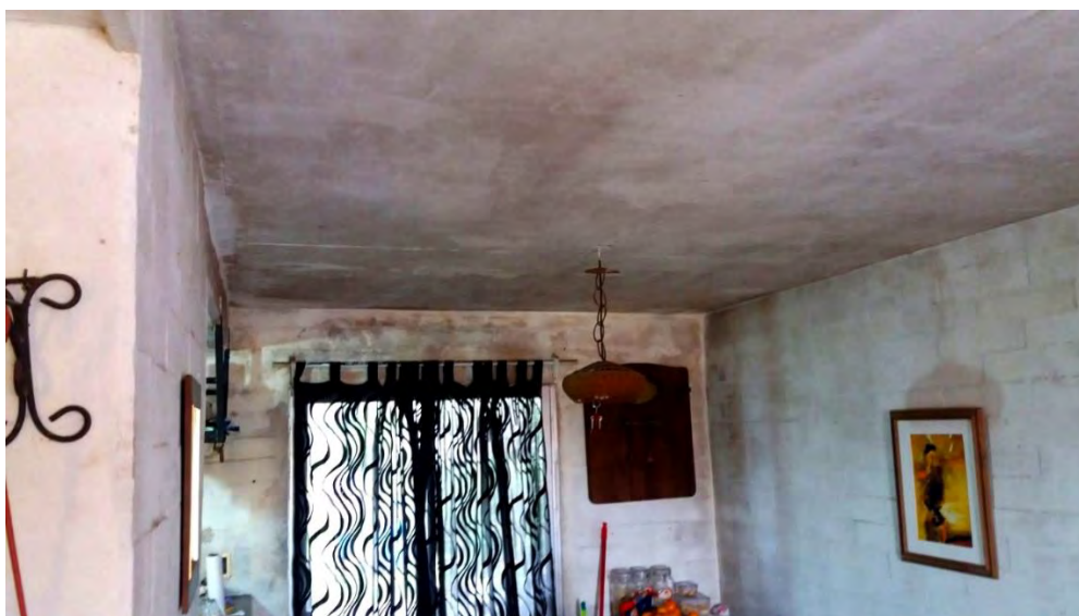
Figura 13: Humedad de condensación en unidad de vivienda de cooperativa COVITOLEDO
