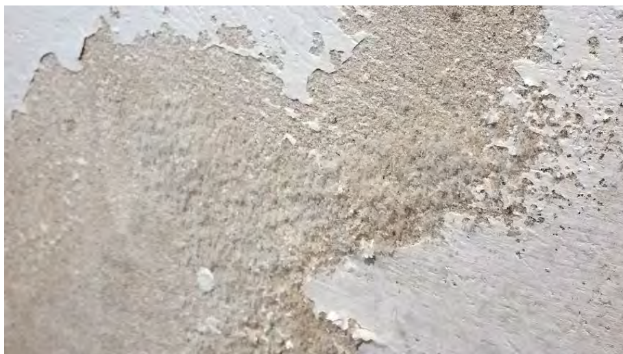
Figura 23: Eflorescencias salinas causadas por condensaciones en el interior del muro. Vivienda en Montevideo.
