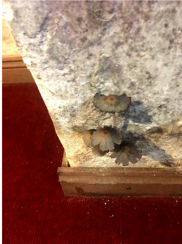
Figura 42: Seta creciendo sobre el zócalo de una vivienda con problemas de alto contenido de humedad en el interior de los materiales atribuibles a diversas causas. Vivienda en Montevideo.
