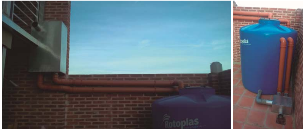
Fig. 4 Dispositivo instalado en edificio Güemes esquina Córdoba – Ciudad de Santa Fe
