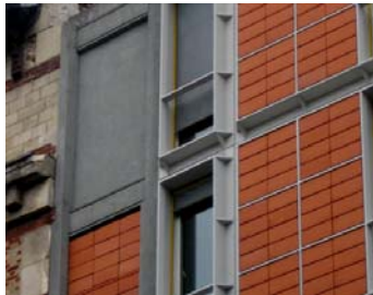
Fig.Nº 1- Hoja Exterior de Fachada de Viviendas Rue des Meux. Placas Ceramicas enmarcadas
