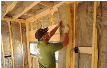
Fig. N° 9. Lana de vidrio con papel kraft que rellena el espacio entre montantes. Fuente : Internet
