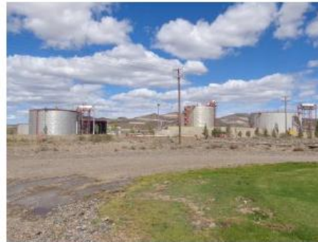
Planta de Tratamiento de Crudo
