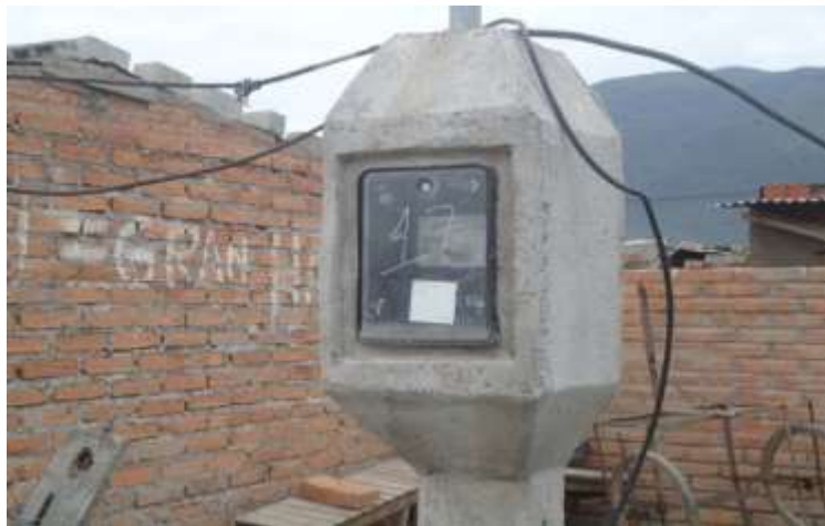
Medidor colocado por EDESA en diciembre de 2015.
