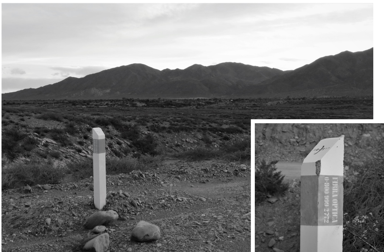
Hitos de hormigón utilizados para la identificación del enlace de fibra óptica y las cámaras de paso y de empalme. Colocados cada 1 Km. La foto fue tomada en el km 4551 de la ruta 40 (Provincia de Salta)
