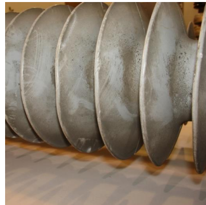
Fig. 13. Material biológico en la zona inferior de un aislador line-post.
