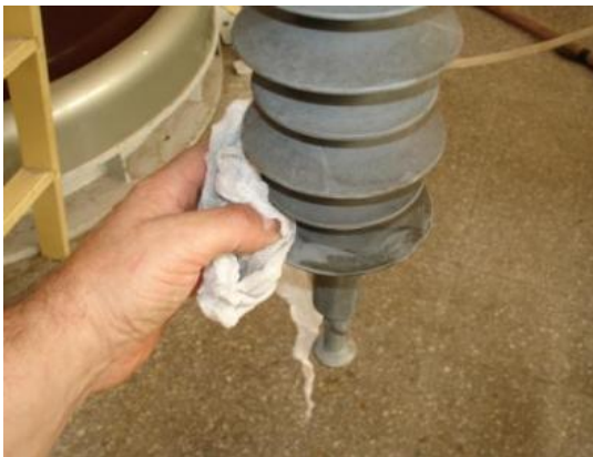
Fig. 6. Extracción del material de uno de los aisladores de suspensión
