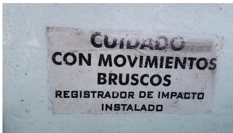
Figura 2.19 - Cartel de registrador de impacto sobre el transformador.
