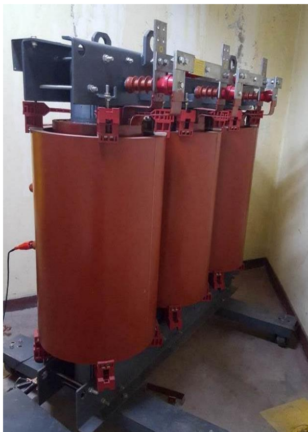
Figura 2.4 - Transformador de excitación. 13,8/0,54 kV; 900 kVA.
