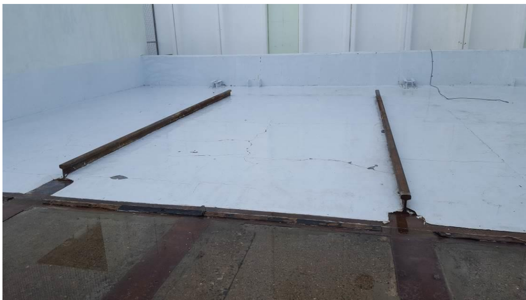
Figura 2.24 - Rieles para el emplazamiento del transformador.
