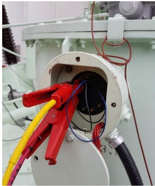
Figura 4.2 – Bornera de terminales secundarios de los TC de un bushing.
