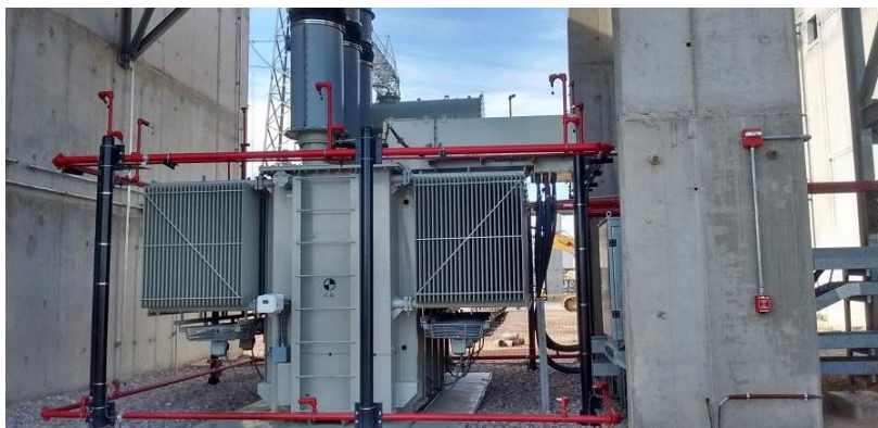
Figura 2.3 - Transformador de servicios auxiliares de central ciclo combinado.
