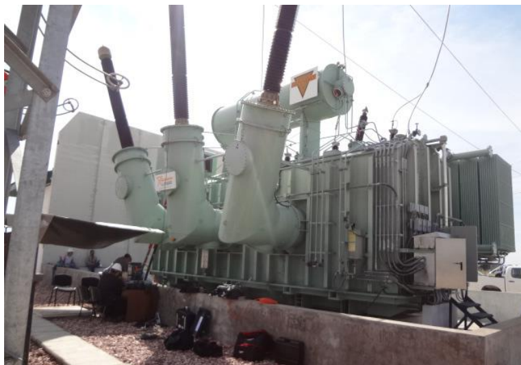
Figura 2.5 - Transformador de potencia. 500/138/34,5 kV; 300 MVA.
