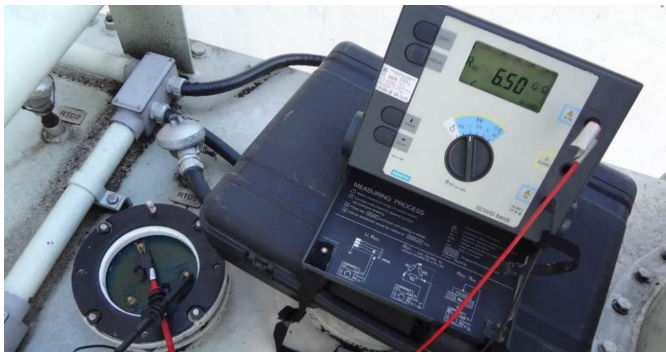
Figura 4.7 – Medición de resistencia de aislamiento del núcleo.
