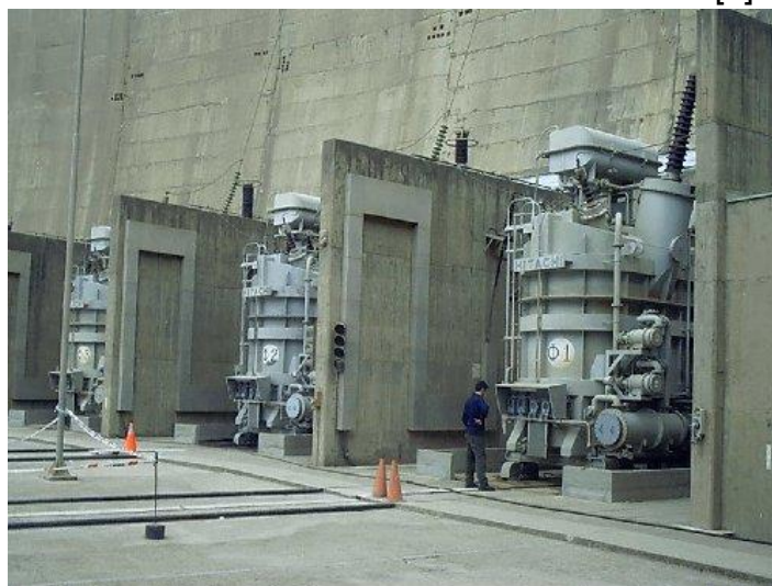
Figura 2.7 - Banco de transformadores monofásicos de la central hidroeléctrica Rapel, Chile.
