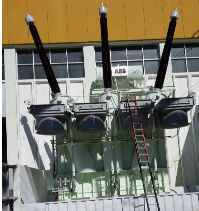
Figura 2.2 - Transformador GSU de central hidroeléctrica. 13,8/330 kV; 140 MVA.
