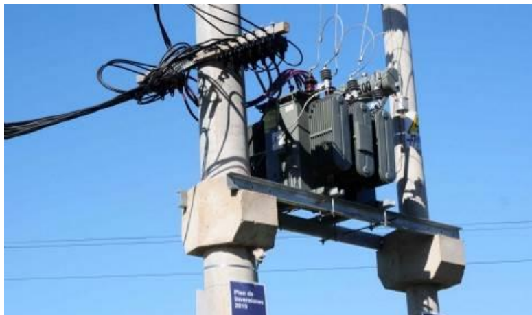
Figura 2.6 - Transformador de distribución.
