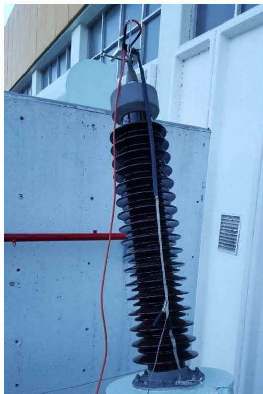
Figura 4.9 – Conexión del cable de medición de FRA en el bushing de neutro.
