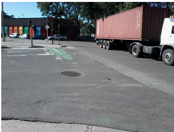
Foto 10. Bicisenda con clara falta de mantenimiento (sin pintura demarcatoria en la sección transversal a una vía para transporte motorizado)
