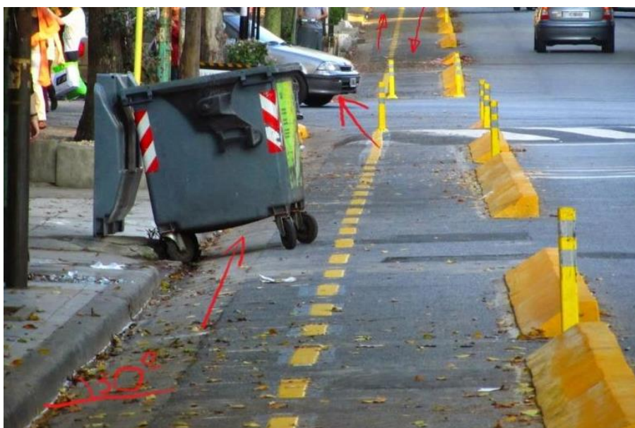
Foto 8. Se observan los graves errores en la disposición de las bicisendas: doble sentido en calle de simple circulación de motorizados, inclinación lateral, existencia de lomos de burro, dos tipos de asfalto en una de las vías de circulación, demarcadores laterales de concreto, pintura deslizante, usos “alternativos” del espacio asignado a bicisendas
