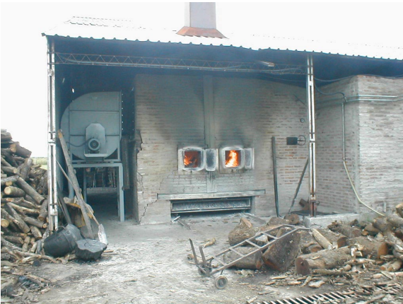
Figura 1. Vista del horno, cenicero, moto ventilador y chimenea
