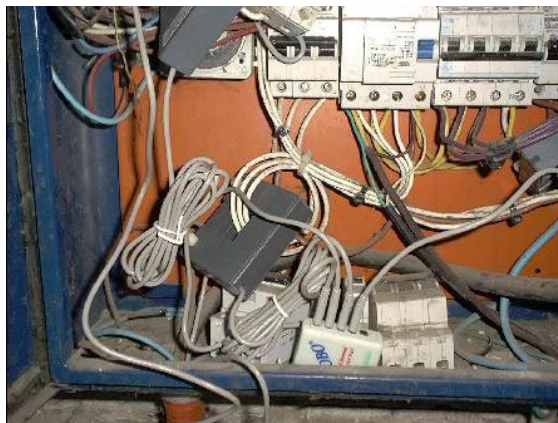
Figura 0: Sensores AC en tablero eléctrico.
