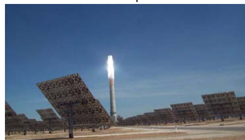
Figura 2. Torre Solar Gemasolar Sevilla 20Mw
