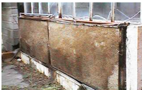
Fig. 2.- Panel de enfriamiento evaporativo, vista exterior.
