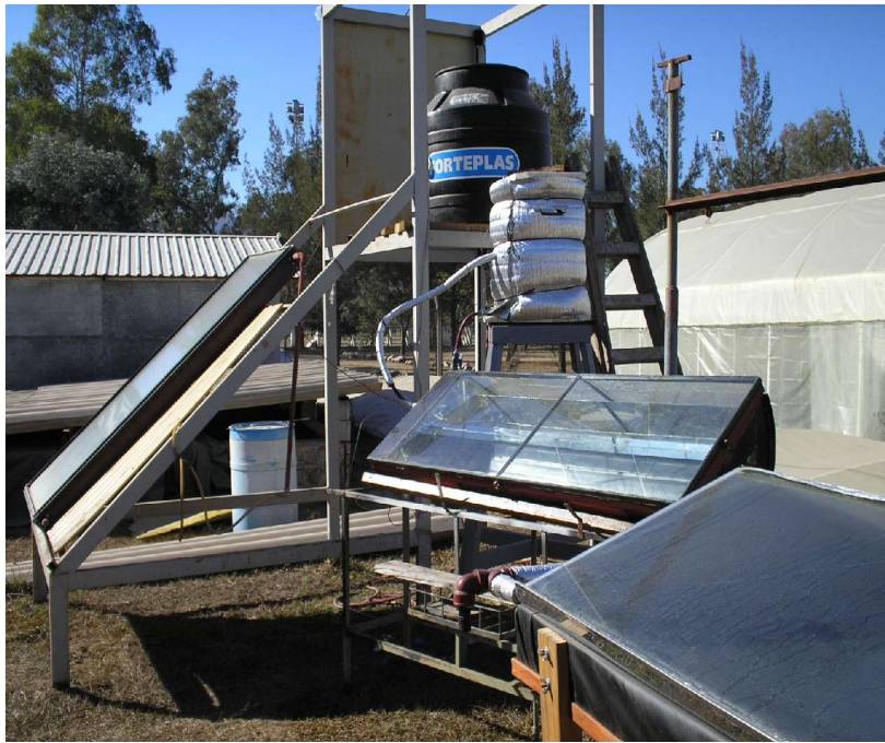
Figura 5: CPC con su tanque de acumulación
