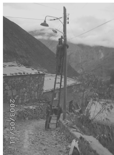
Figura 6: instalación alumbrado público
