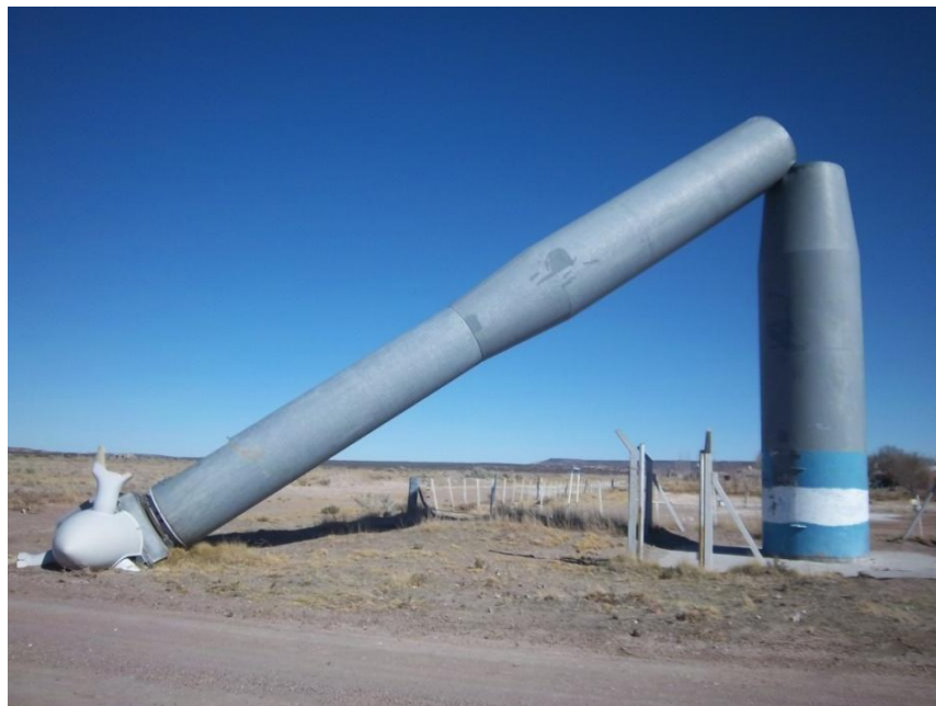
Fig. 4.11: Torre colapsada en El Cuy, provincia de Río Negro.
