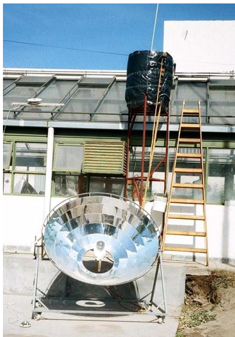
Fig.1. Vista general del equipo de calentamiento
