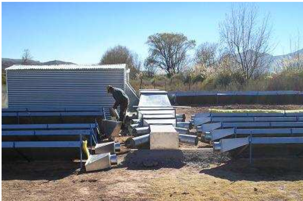
Figura 4: Vista posterior del caño maestro en la etapa de construcción del sistema. Se observan también las campanas de reducción que se coloca en el extremo del colector y que están enfrentadas a los tramos de caño de 20 cm de diámetro.
