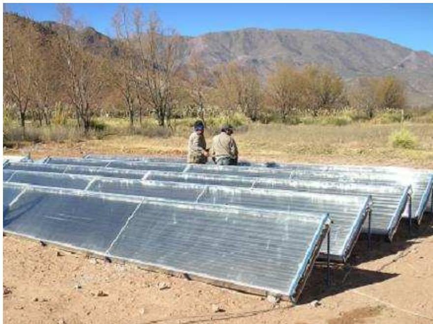
Figura 2: Foto del banco de colectores de aire. Se muestra el extremo por donde ingresa el aire ambiente
