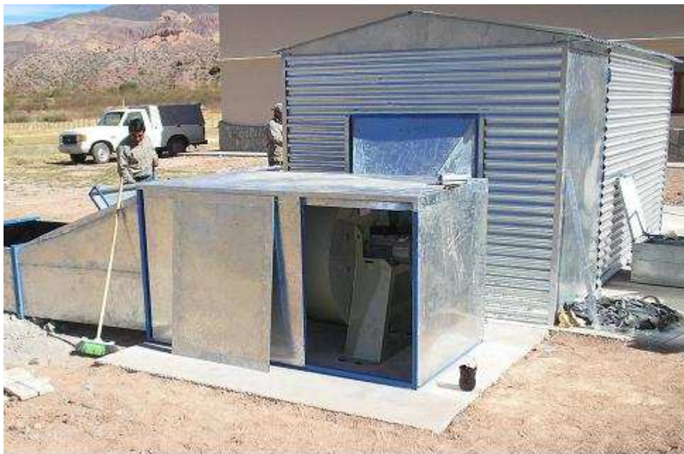
Figura 6: Vista posterior del cajón de distribución. Se observa el ventilador centrífugo de 1,5 kw. Delante del mismo, al comienzo del cajón, se colocan los filtros de aire.
