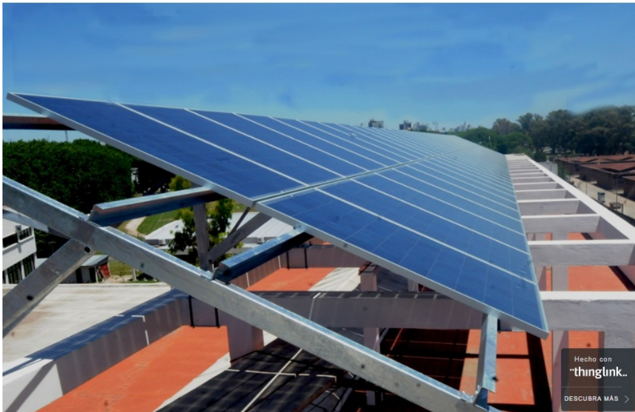
Figura 29: instalación fotovoltaica piloto en la terraza del edificio de la Facultad, ubicado en Calle 50 y 120 de la ciudad de La Plata
