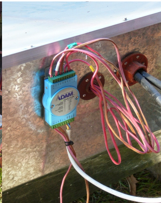
Figura 3: Datalogger y conexiones
